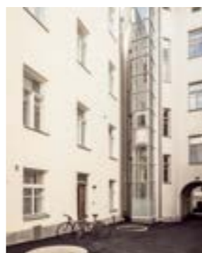
Ascenseur installé à l'extérieur du bâtiment dans une gaine externe. Ascenseur installé à
